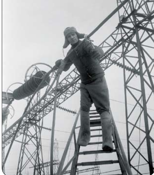
Проверка последней гирлянды высокого напряжения I-го агрегата. Монтер испытательной лаборатории В.В. Морозов испытывает плотность опрессованных клемм
