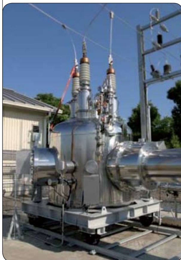
Рис. 15. Вход ВТСП кабеля SEI в коллектор в г. Олбани
