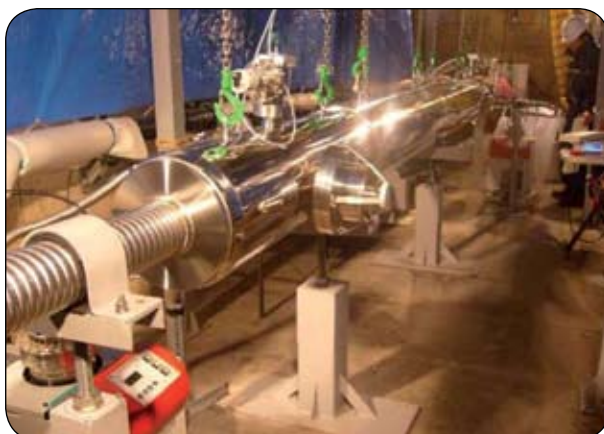
Рис. 13. Соединительная муфта (до покрытия водонепроницаемыми лентами) ВТСП кабеля 34,5 кВ в г. Олбани
