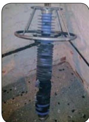
Демонтированный ОПН. Видны следы пробоя и выгорания изоляции
