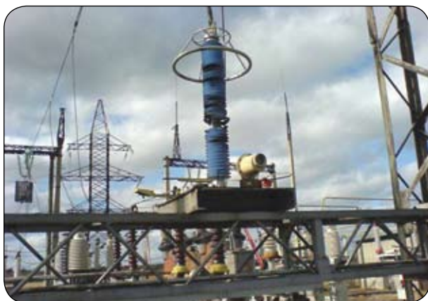
Поврежденный ОПН на подстанции
