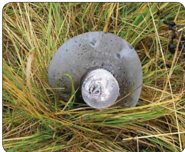
Пробитый изолятор ШПУ-10-А (ПО «ЮЭС» Комиэнерго)
