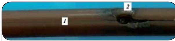
Рис. 10. Внешний вид изолированной жилы кабеля с трещиной: 1 — трещина, 2 — выплавление изоляции в месте пробоя
