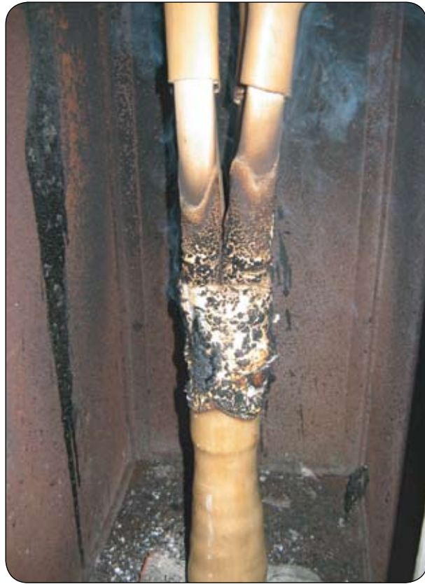
Муфта КВтнг-10 (после испытания на огнестойкость)
